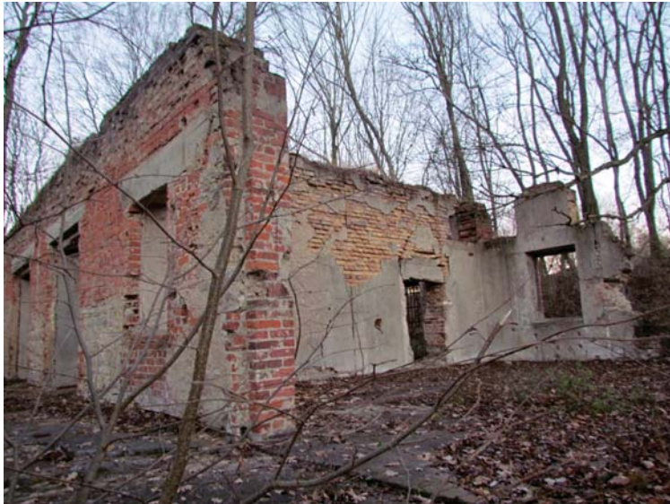
Abb. 33 Überreste der Transformatorstation II, 2016
