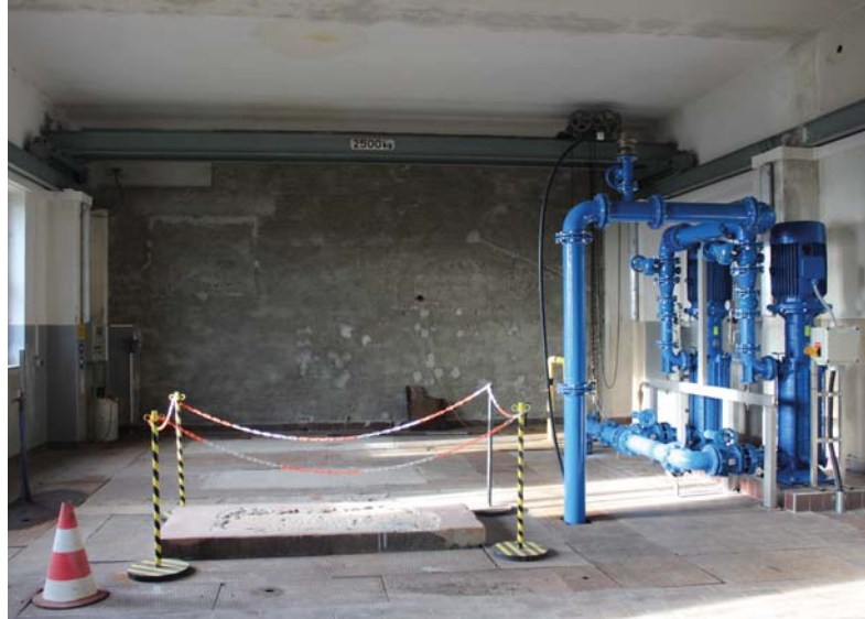
Abb. 24 Maschinenraum der Druckerhöhung, 2016
