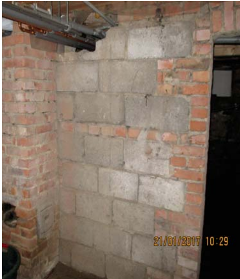
Abb. 42 Verbaute Steine im Keller, 2017
