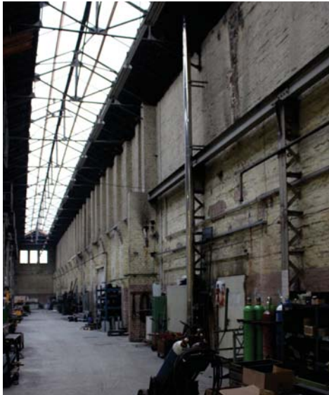
Abb. 33 Bruch in der Wand, durchgängig identisch erscheinende Dachbinder, 2016
