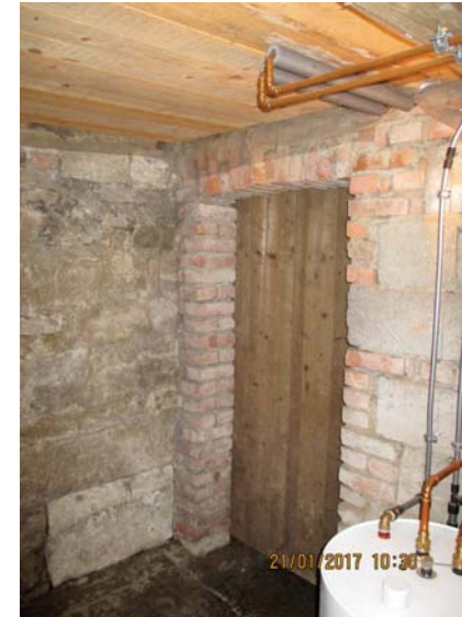
Abb. 44 Verbaute Steine im Keller, 2017
