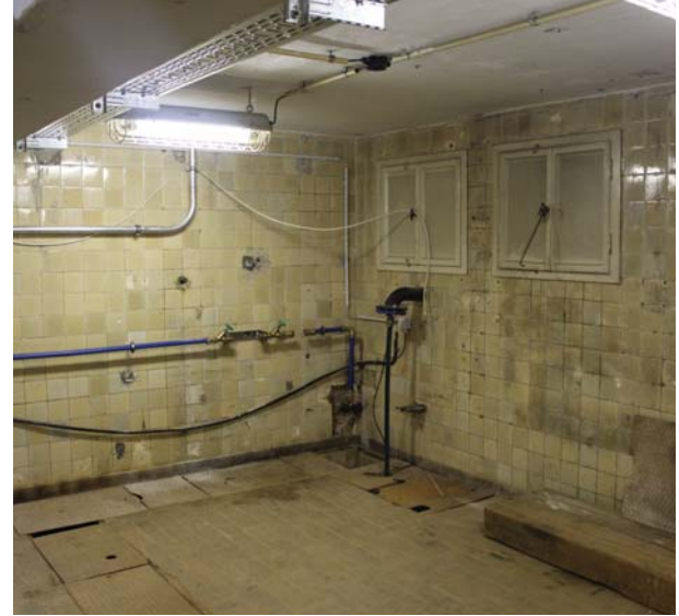
Abb. 21 Innenraum Brunnenhaus Tonndorf II, 2016
